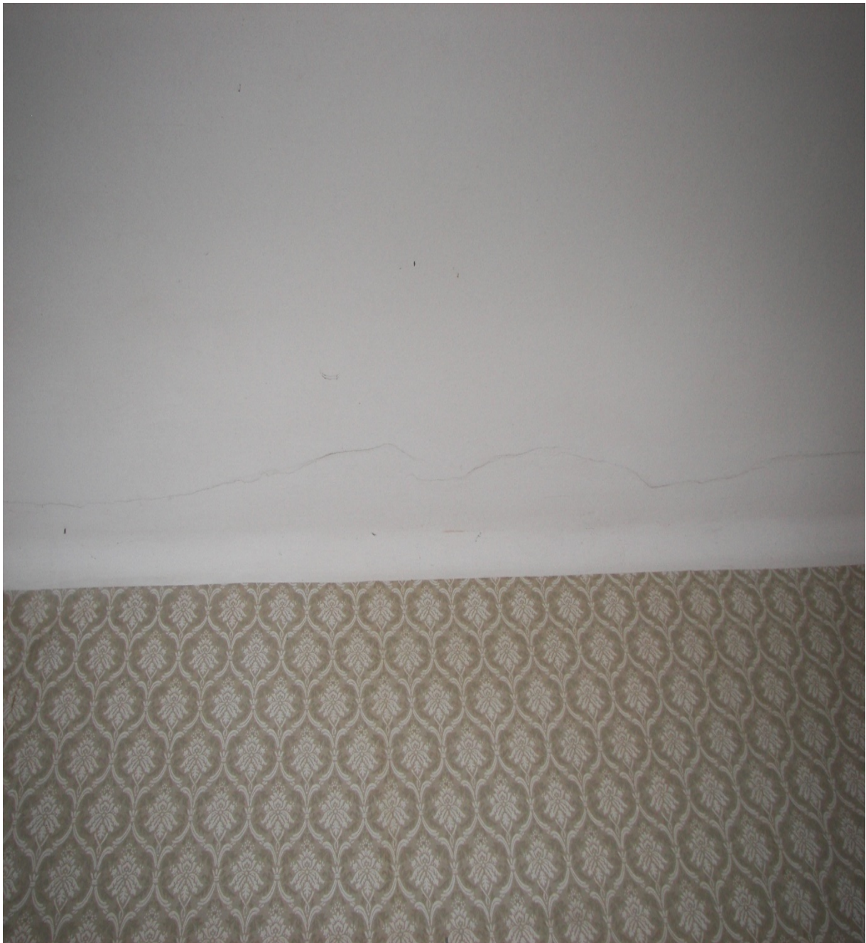
FOTO 13. VIVIENDA 4 a PLANTA. Vista de fisuras en techo de vivienda habitada del forjado de cubierta, en la zona correspondiente al encuentro de la fachada exterior con el forjado.
