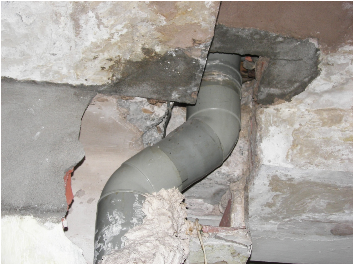
FOTO 7. LOCAL PRIMERA PLANTA. Vista de bajante del techo del local de primera planta, se puede observar como las pérdidas de dicha bajante han producido acumulación de humedades a su alrededor.
