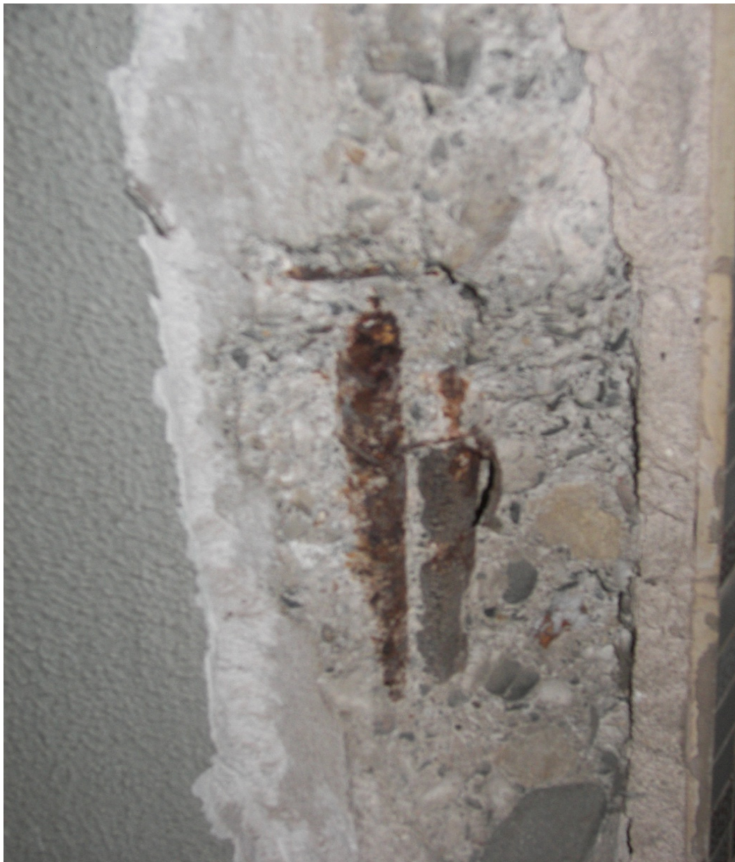
FOTO 8. LOCAL PRIMERA PLANTA. Vista de armadura longitudinal del pilar correspondiente a un pilar de la primera planta. En esta cata se puede observar síntomas de corrosión en la armadura longitudinal.
