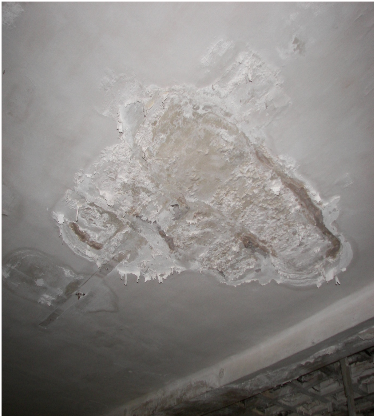
FOTO 10. LOCAL PRIMERA PLANTA. Vista de las manchas de humedad en el techo del local de primera planta, debido a la infiltración de agua desde los cuartos húmedos de la planta superior.
