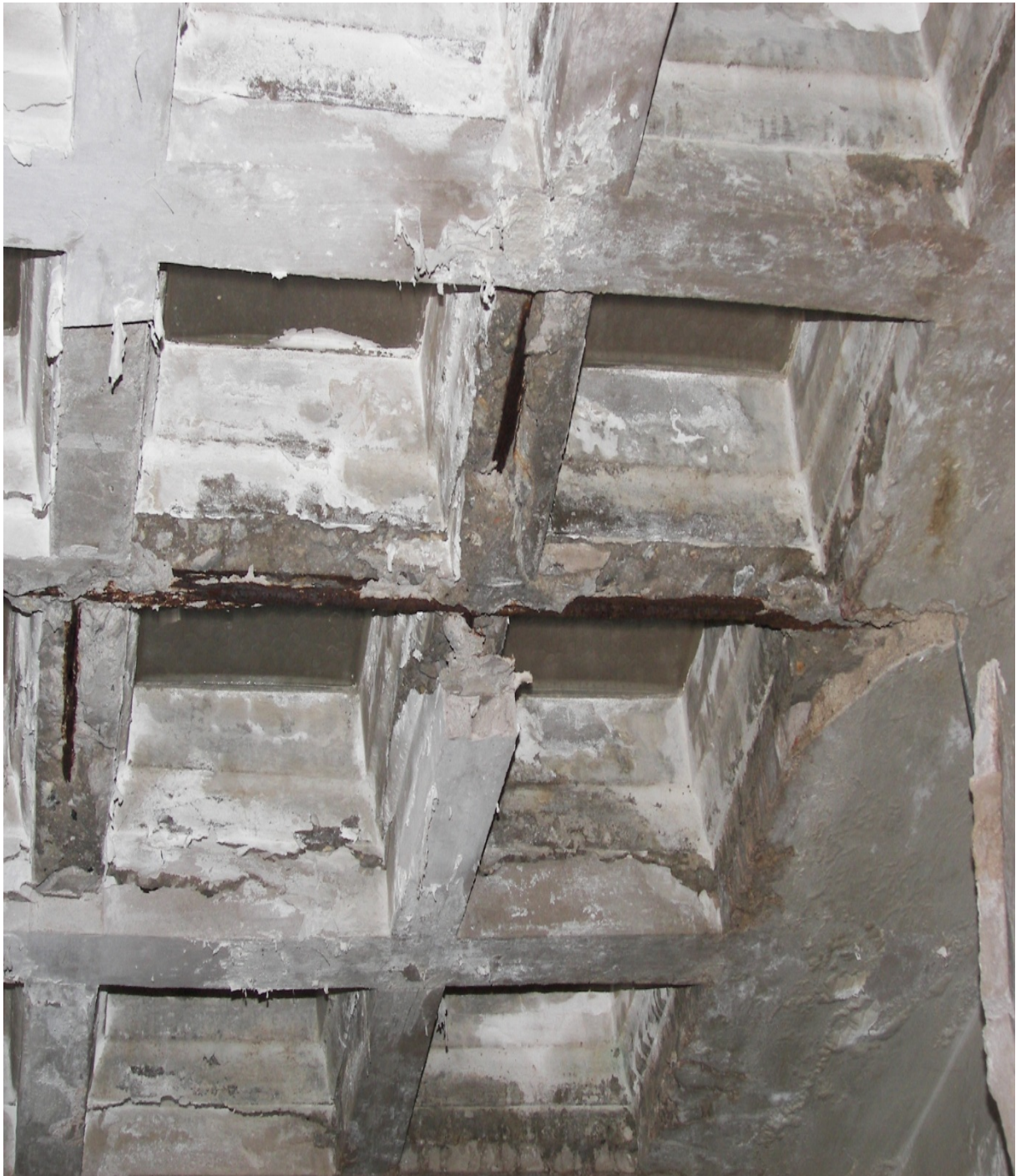
FOTO 6. LOCAL PRIMERA PLANTA. Vista de las patologías que afectan al lucernario, se puede observar la corrosión de las armaduras del mismo y el desprendimiento de algunas zonas.
