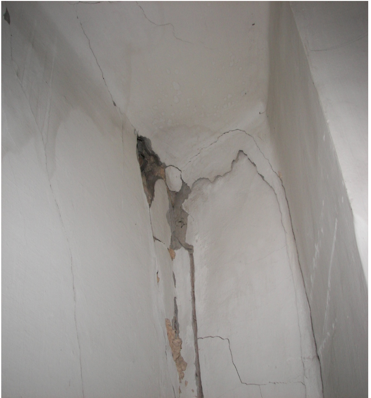
FOTO 12. LOCAL PRIMERA PLANTA. Vista de desperfectos en cerramiento de fachada medianera.
