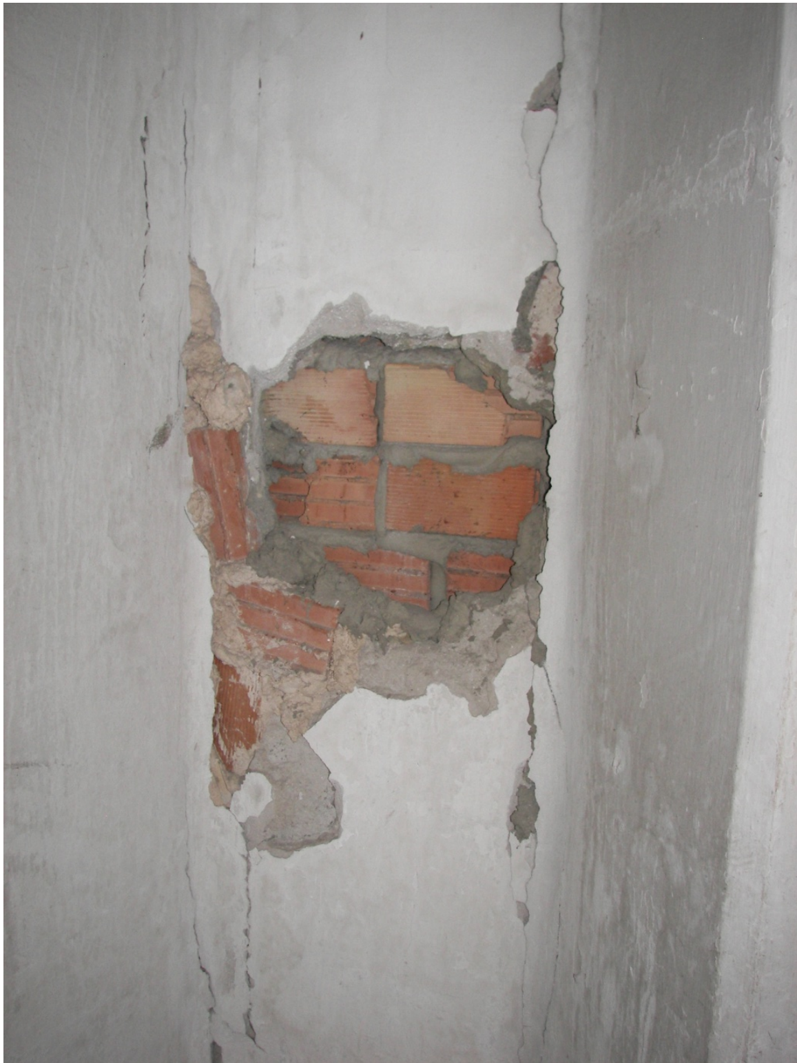
FOTO 11. LOCAL PRIMERA PLANTA. Vista de desperfectos en fábrica de ladrillo perteneciente al cerramiento de fachada medianero con el edificio anexo.
