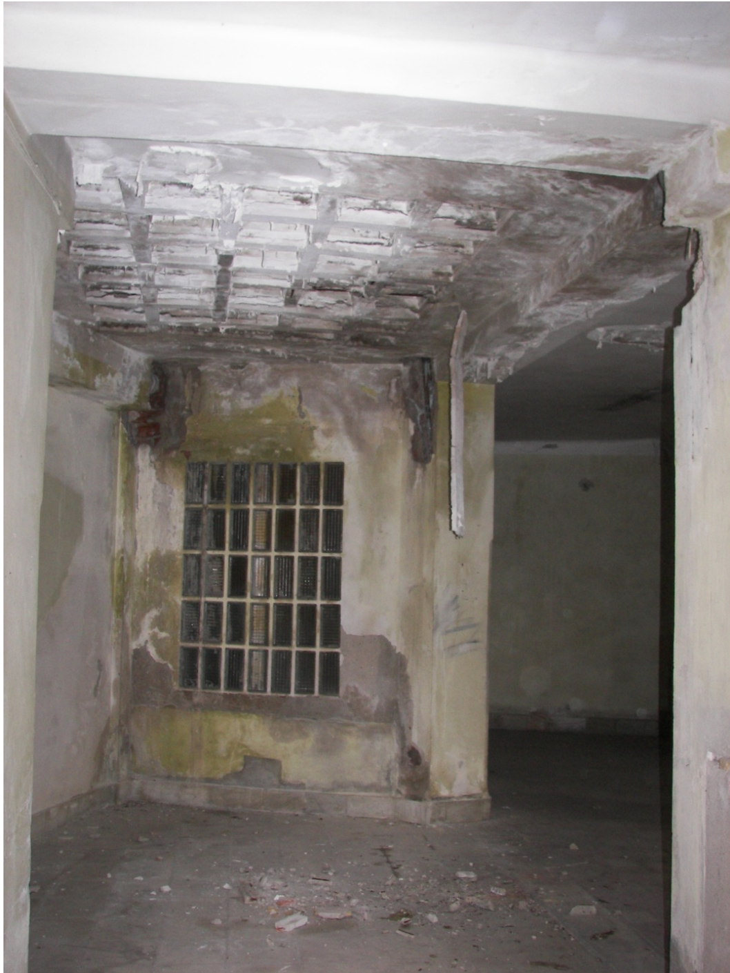
FOTO 4.LOCAL PRIMERA PLANTA. Vista del lucernario afectado por patologías con origen en la corrosión, y desprendimiento posterior de los elementos que lo componen.
