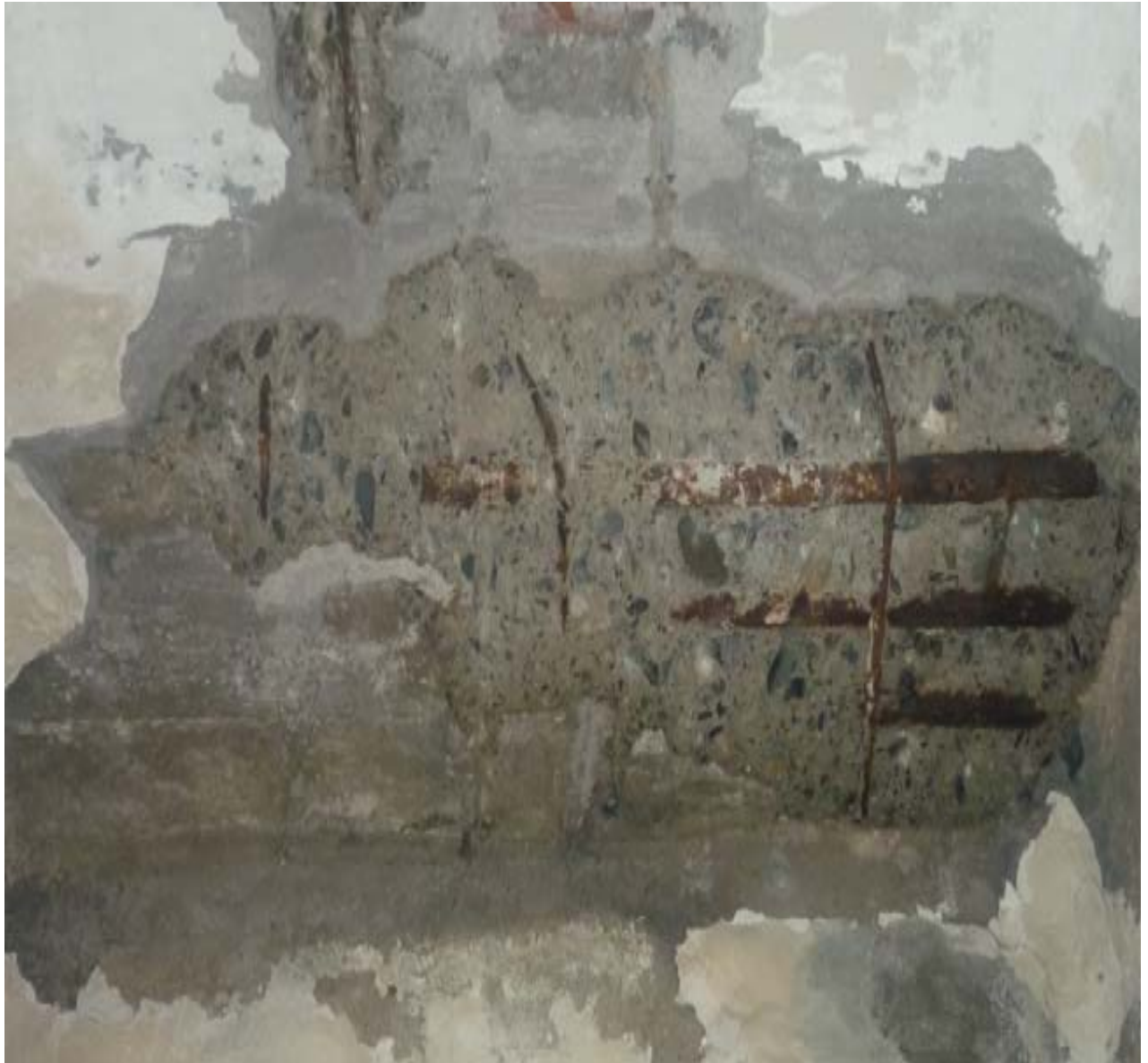
FOTO 14. VIVIENDA 4ª PLANTA. Vista de cata en viga de borde con claros síntomas de corrosión, esta viga delimita el forjado de cubierta y la fachada del edificio.
