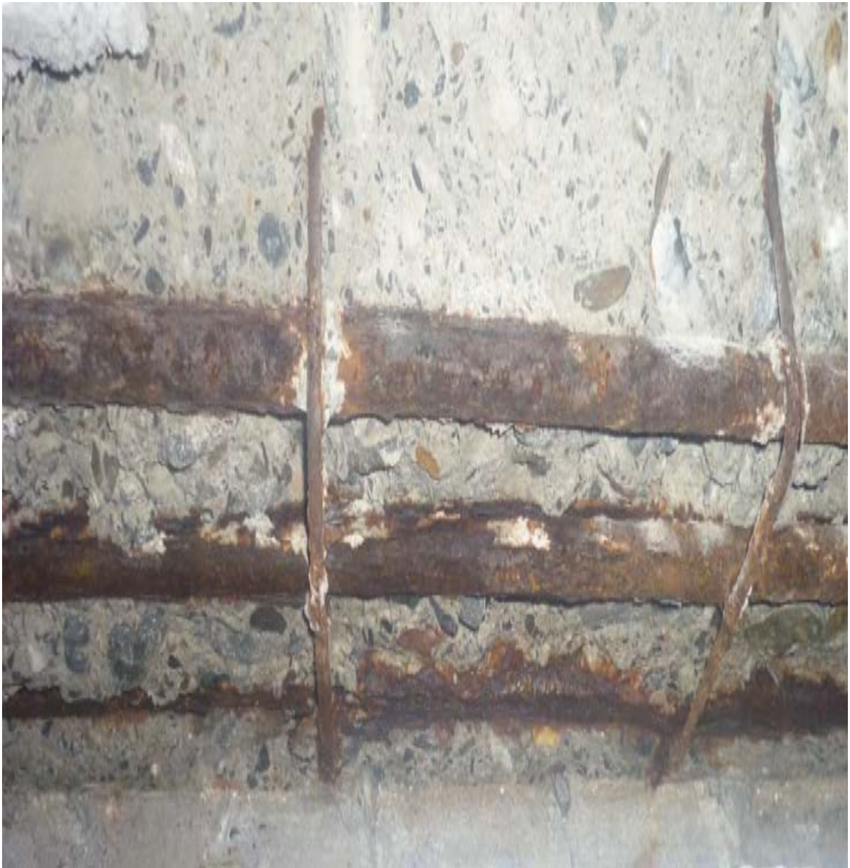
FOTO 15. VIVIENDA 4ª PLANTA. Vista de viga de borde de forjado, con armaduras en avanzado estado de corrosión con pérdida de sección, correspondiente a forjado de cubierta.
