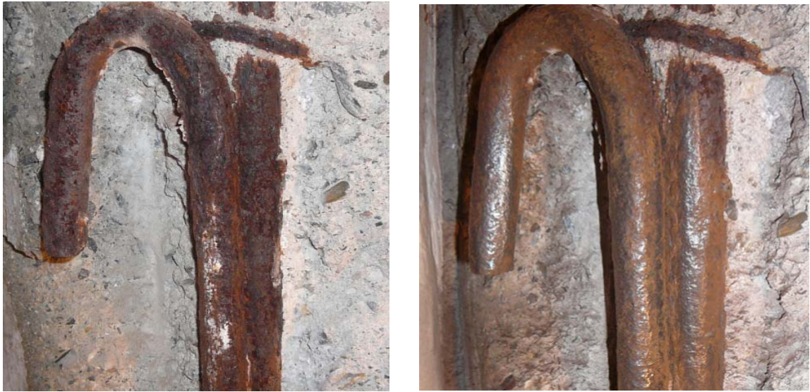
FOTO 25.-PÉRDIDA ESPESOR ARMADURA PILAR PLANTA 4
