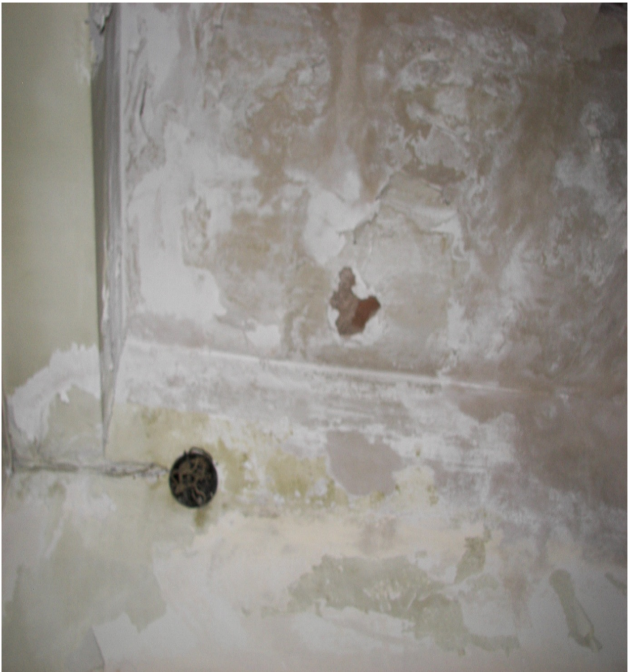
FOTO 5. LOCAL PRIMERA PLANTA. Vista de zona de humedades por infiltración de agua junto al lucernario de la primera planta.
