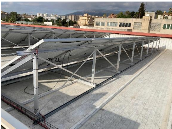
“Proyecto de instalación fotovoltaica de autoconsumo para los edificios de conservación, policía portuaria y sede de la APBA en el Puerto de Algeciras financiado con cargo a los fondos MRR”
