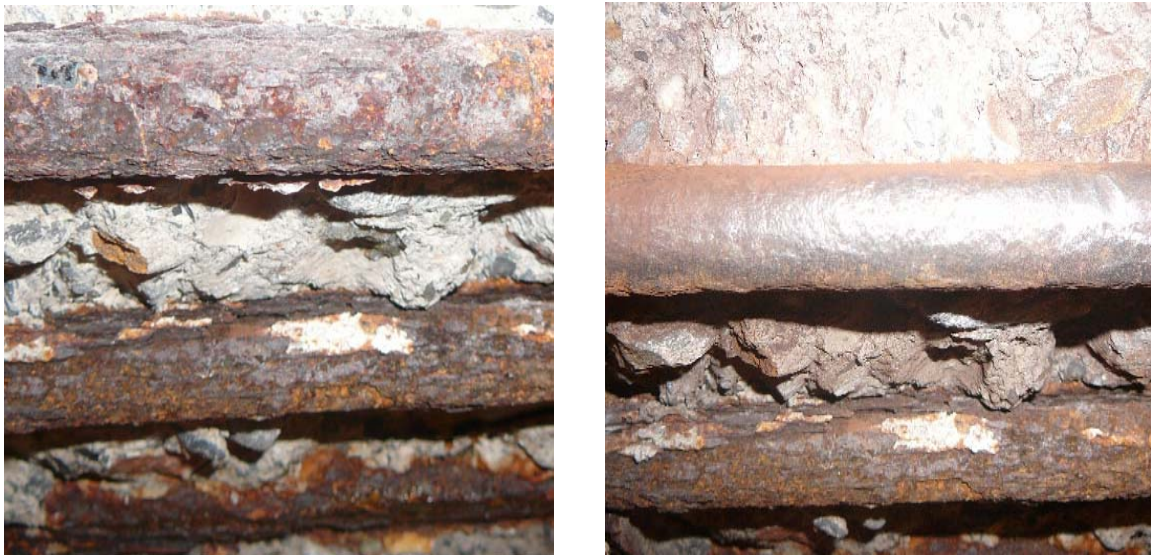
FOTO 24.-PÉRDIDA ESPESOR ARMADURA VIGA FORJADO PLANTA 4
